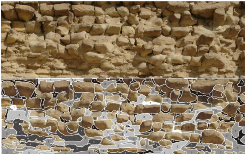
5.13. attēls. Raksturīgas kleķa cementa kompozīta materiāla cementa (AC) tipa dēdēšanas atšķirības. Pakāpju piramīdas dienvidu fasāde; augšējā attēlā – parauglaukuma oriģinālais fotouzņēmums; apakšējā attēlā: 1 - 5 apzīmē cementa dēdēšanas intensitāti.
